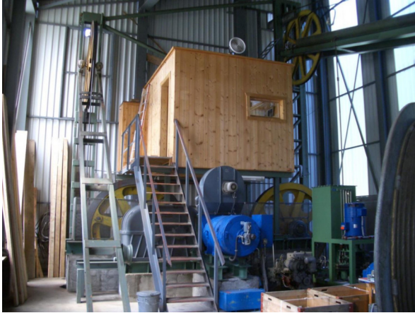
Heiligkreuz, Talstation, Maschinenraum, Kommandoraum (© BAK / Erwin Bloch, CH-3627 Heimberg).
